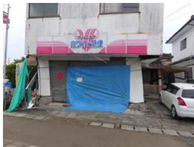
－ 建築物の傾斜 －
