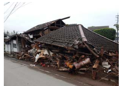
－ 建築物の倒壊 －
